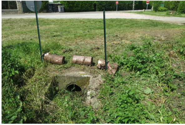
Canalisation pluviale débouchant à quelques mètres de la clôture du périmètre de protection immédiate
