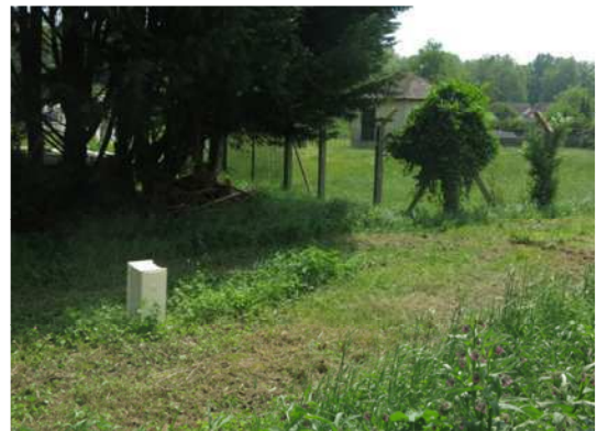
Coffret de branchement électrique desservant la parcelle contenant la caravane
